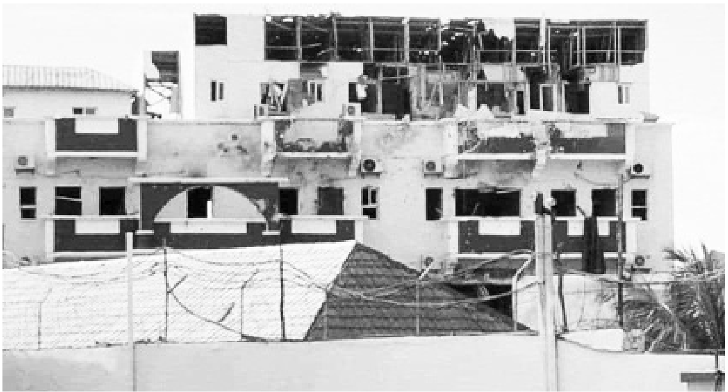
ጉዳት የደበበት ሃያት ሆቴል
